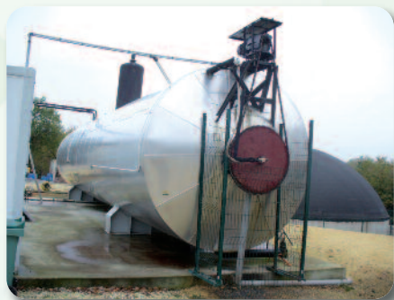
Digesteur piston voie liquide (cas 1)
